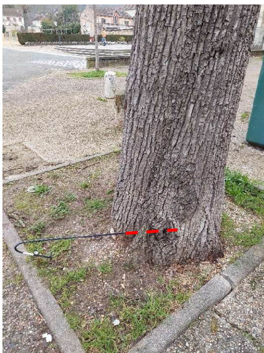
Tilleul n°1 : cavité de 38 cm de profondeur au collet
